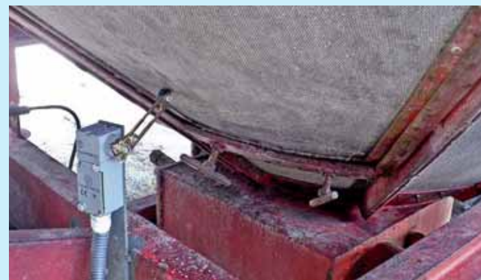
Zamontowana osłona i wykonane zabezpieczenie wyłącznikiem krańcowym, zabezpieczającym przed uruchomieniem napędu bez osłony.
